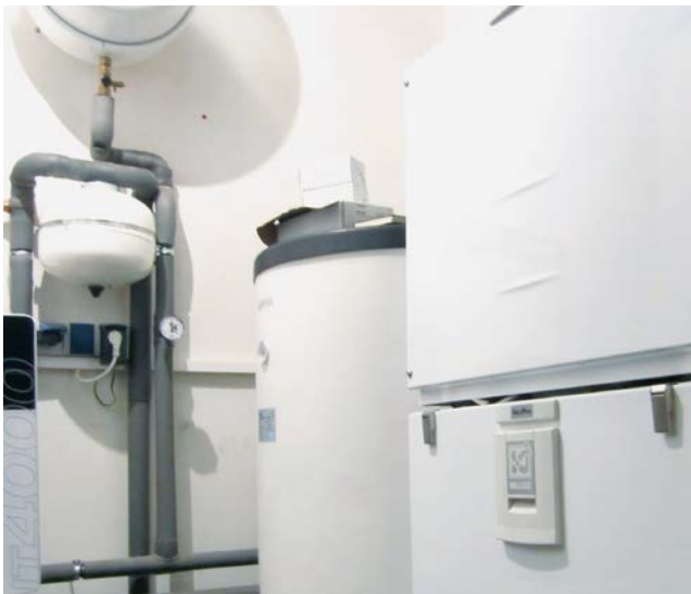
An der Wand ist das zum KWL-System gehörende Hydraulikpaket installiert, das Bestandteil des Erdwärmetauschersystems ist.
