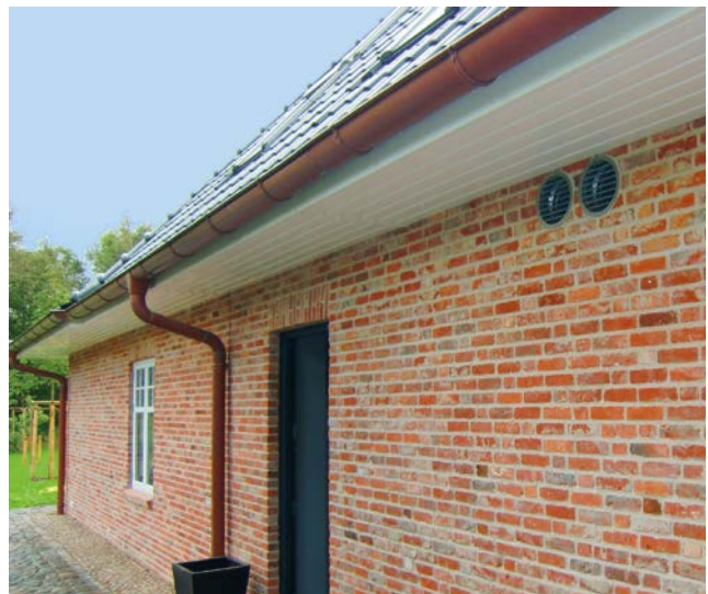
Die Außenwand-Luftdurchlässe für die Außenluft- und Fortluftführung sind unauffällig in die Klinkerfassade integriert.
