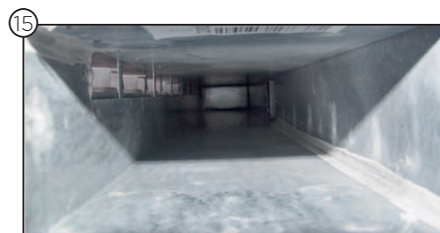
Kanalstrecke vor der Reinigung
